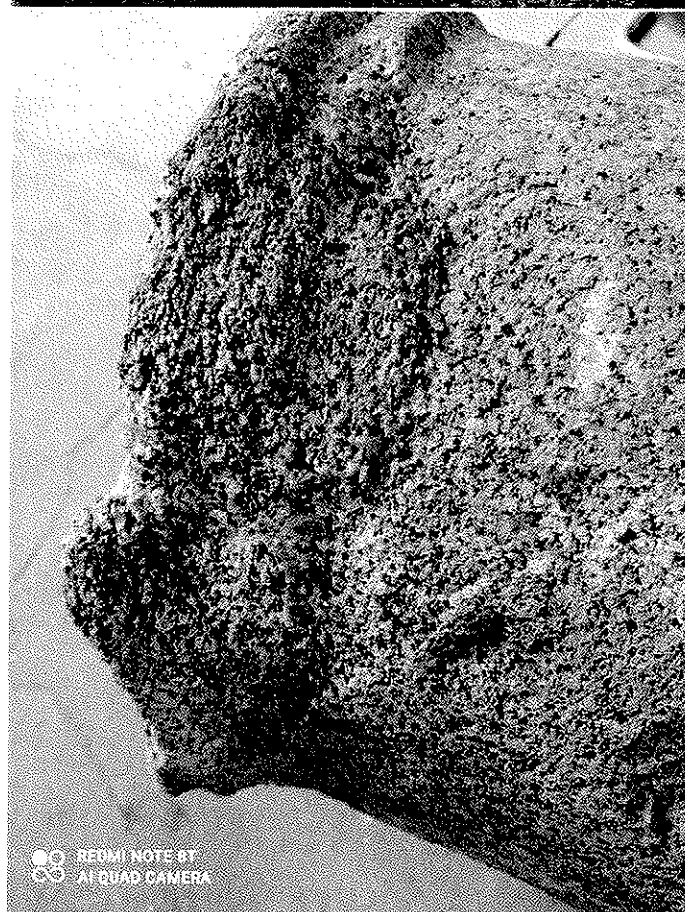
Az oszloptörzs felső rész, a levált részek rögzítése
